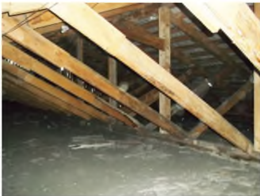
Фото 8 отсутствие огнезащитной обработки деревянных конструкций стропил (корпус 1)
