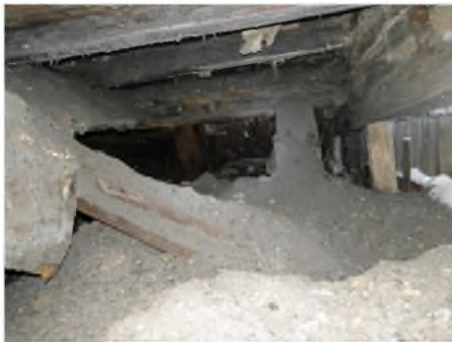
Фото 4 Обрушение участков конструкций цокольного перекрытия в осях Г-Д(4-5)
