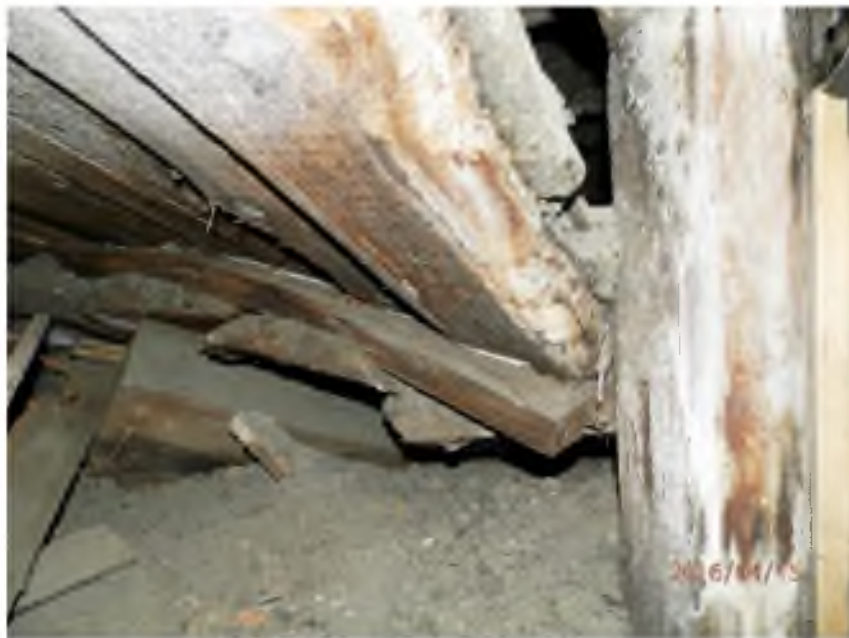
Фото 3 Обрушение участков конструкций цокольного перекрытия в осях В-Д(6-7) Биоповреждения свайного оголовка
