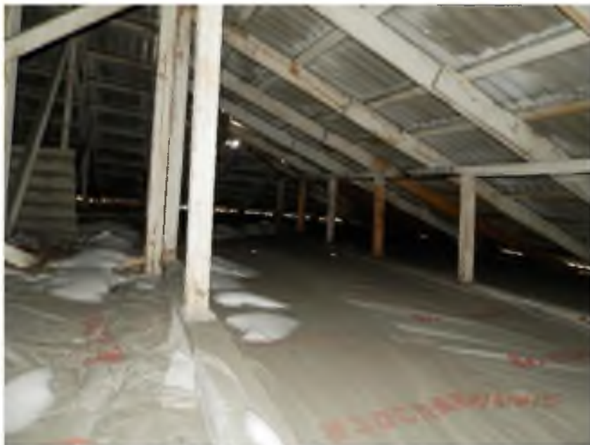
Фото 7 Задувание снега через конструкции конькового соединения кровельного покрытия Б(2-6)
