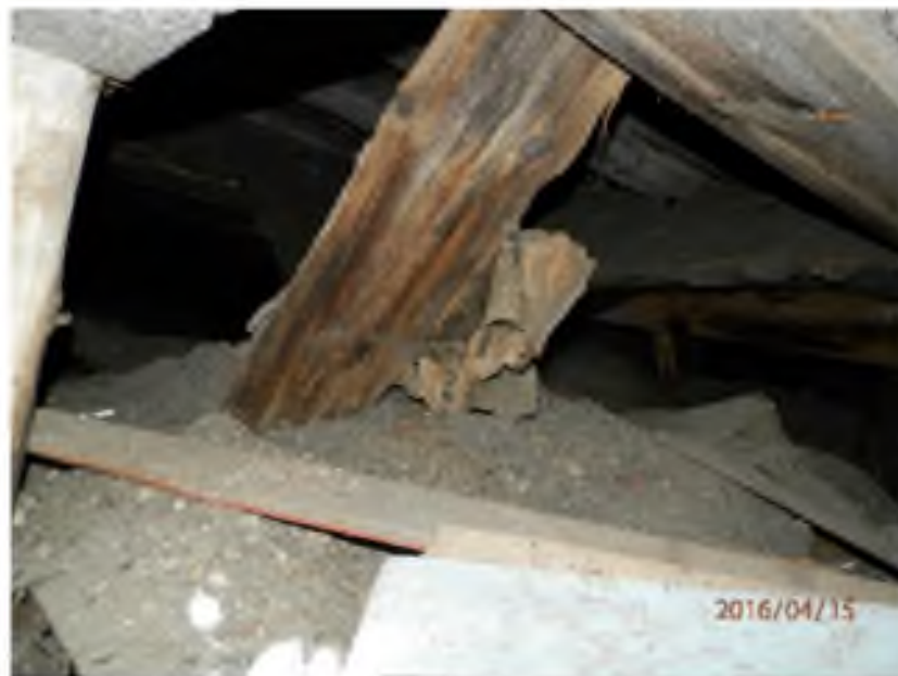
Фото 1 Обрушение участков конструкций цокольного перекрытия в осях Г-Д(4-5)
