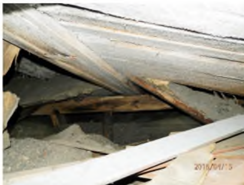
Фото 2 Обрушение участков конструкций цокольного перекрытия в осях В-Д(3-4)
