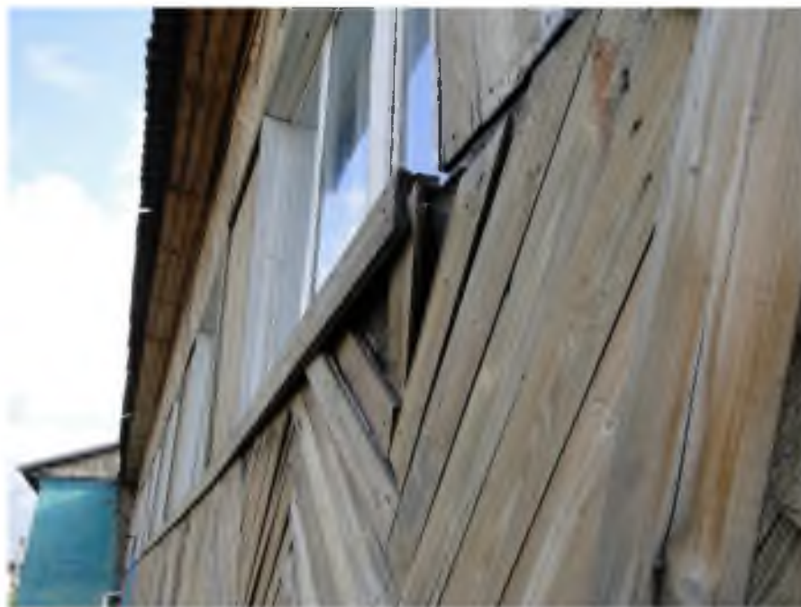
Фото 10 Деформация стены ,нарушение отделки фасада, нарушение геометрии оконных заполнений. Д(3)
