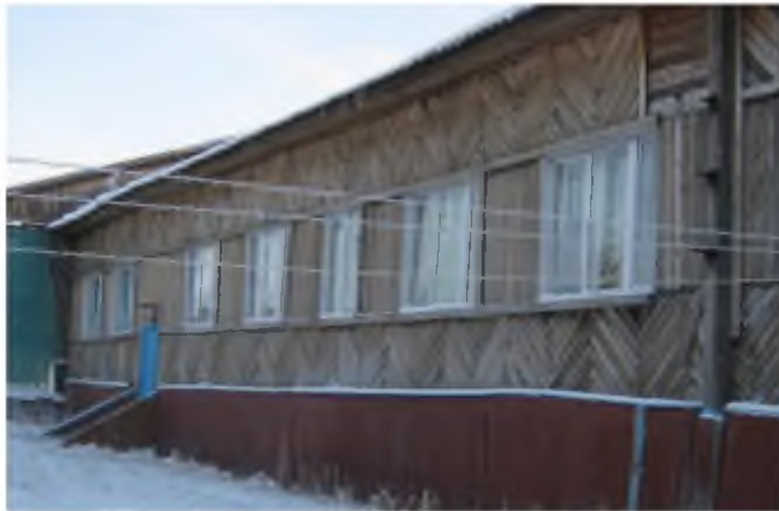
Фото 9 Деформация наружной стены , нарушение отделки фасада, отсутствие вентиляционных продухов технического подполья в конструкции цокольной зашивки. Д(3-7)
